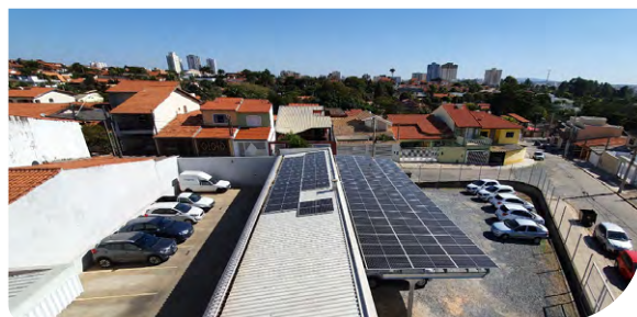
Sistema Carport implantado na MultMed
